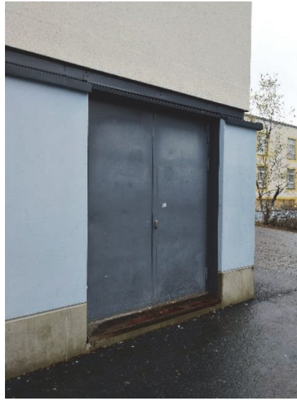
Kuva 8. Kynnys vaurioitunut kosteudesta.
