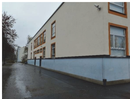
Kuva 6. Maanpinta kaataa rakennuksesta pois päin ja kohti kaivoa.
