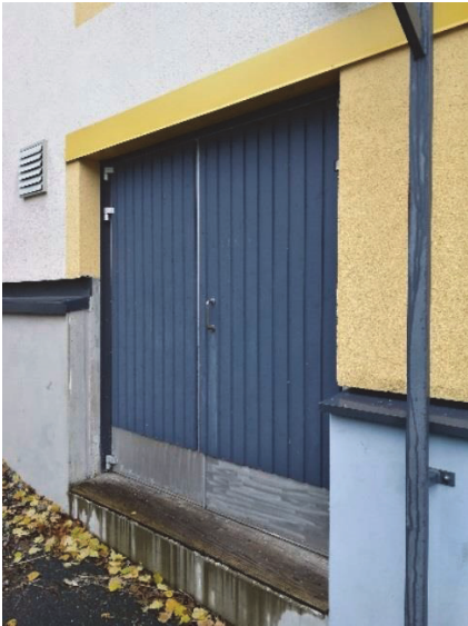
Kuva 7. Kynnys vaurioitunut kosteudesta.
